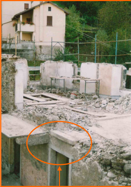
Edificio in demolizione: zona dove si trovava l'infortunato prima della caduta
