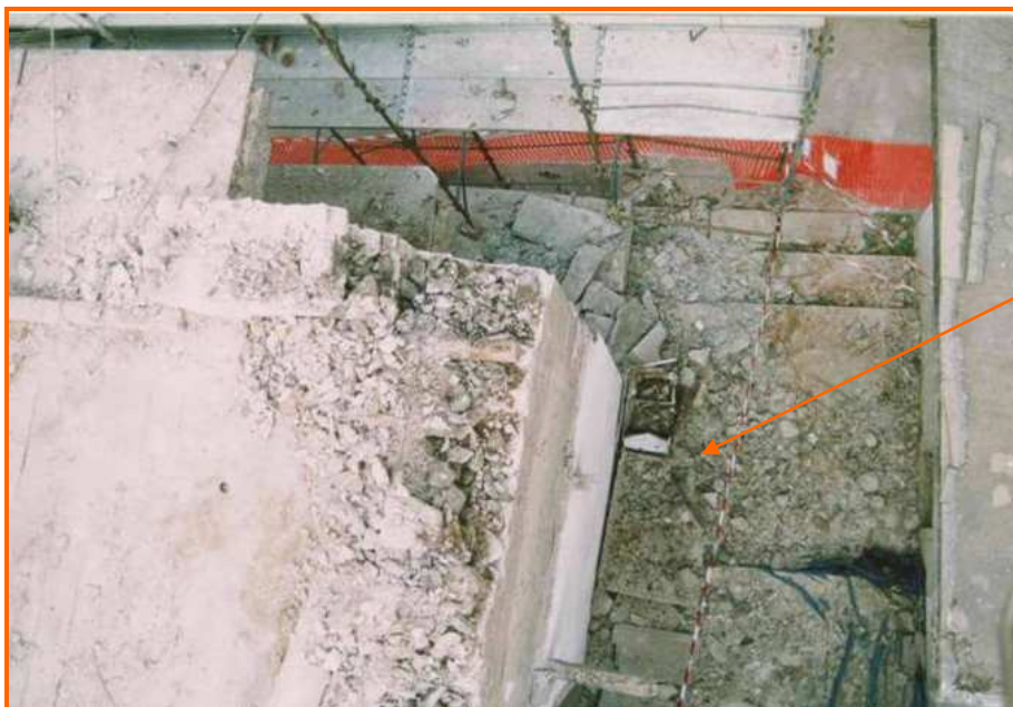
Vista dall'alto delle macerie del balcone caduto
